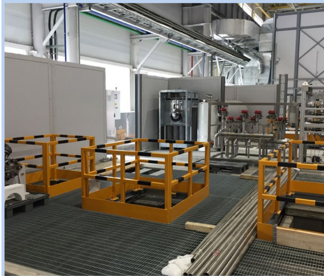
Комплекс криогенных и газовых испытаний
